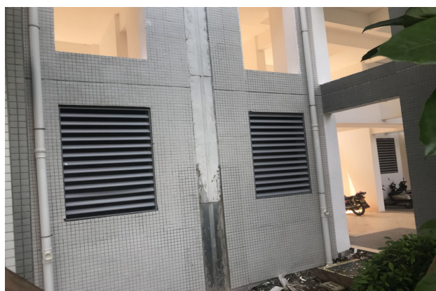
地下室停车场排风口
