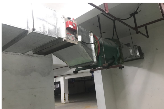
地下室通风换气管道
