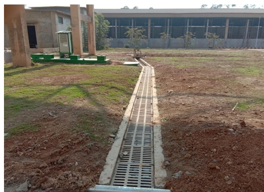
雨水收集管网
