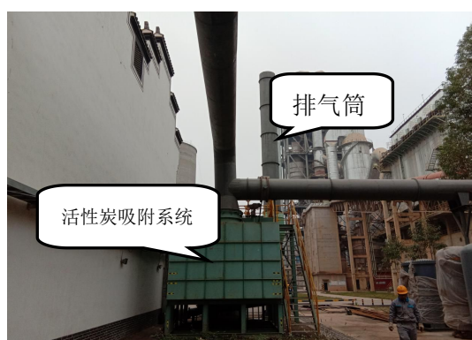
固废暂存间废气处理系统
