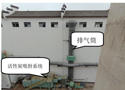
固废存储间废气处理系统
