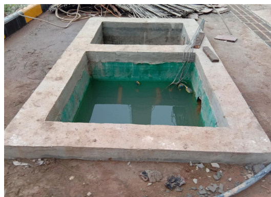
暂存间沉淀池
