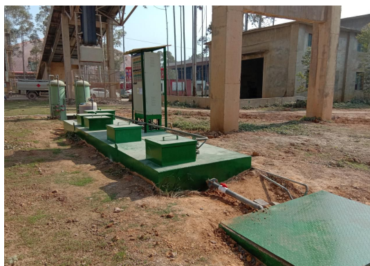
一体化生活污水处理装置
