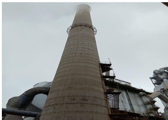
窑尾排气筒（90m）
