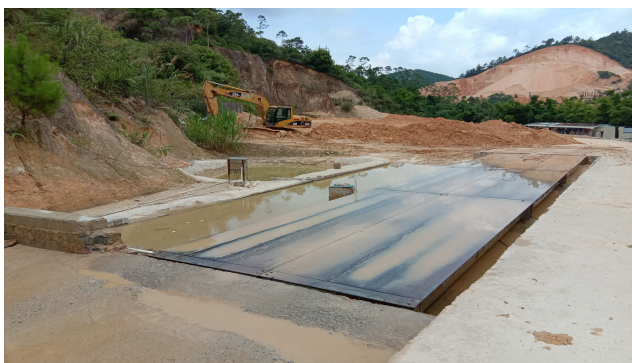
洗车废水沉淀池
