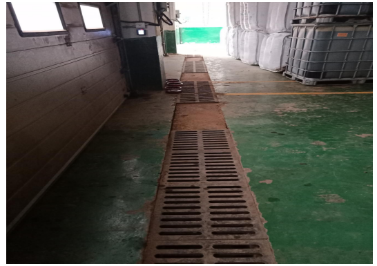
存储间废液收集沟
