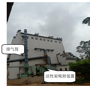
固废存储间、暂存间废气处理设施
