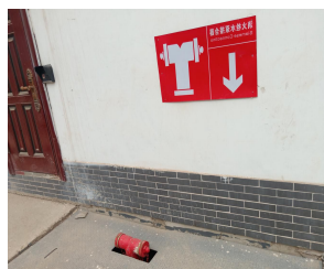
消防栓水泵接合器
