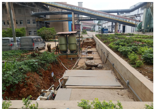
生产区生活污水处理设置
