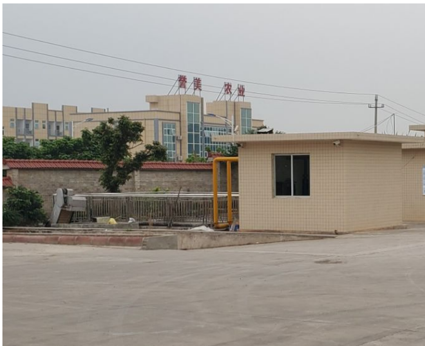
图 4-2 本项目污水处理站
