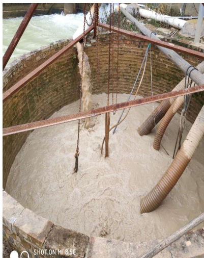
生产废水回收池
