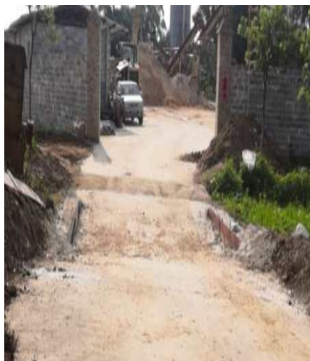
进出口车辆冲洗台
