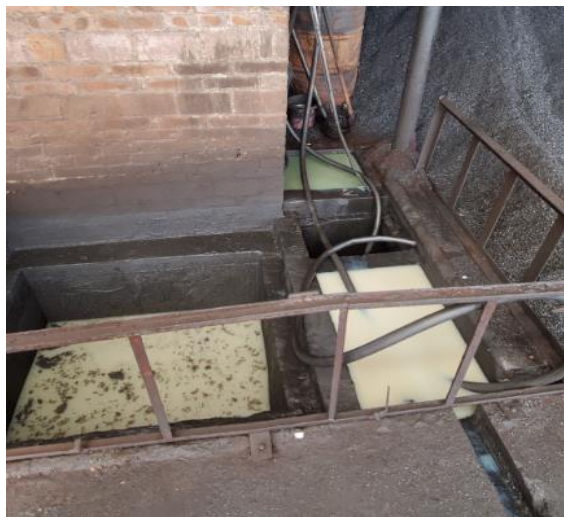
图 5 切削液沉淀池
