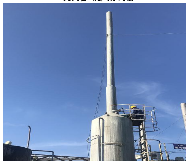
碱洗塔排气筒
