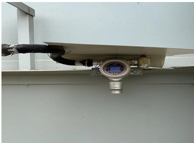
煤气柜固定式 CO 气体检测仪
