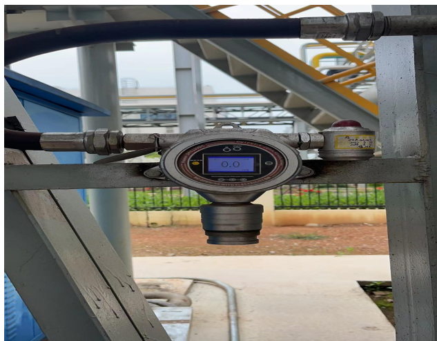
煤气管道固定式 CO 气体检测仪
