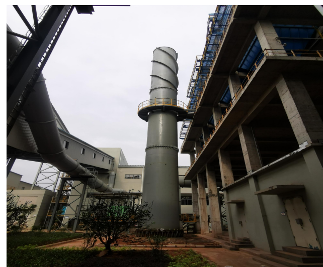
烧结破碎排气筒
