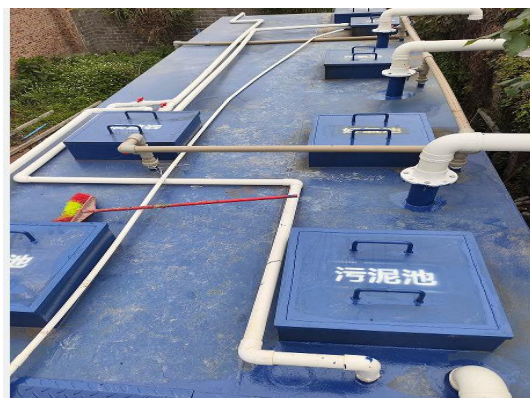
污水处理设施
